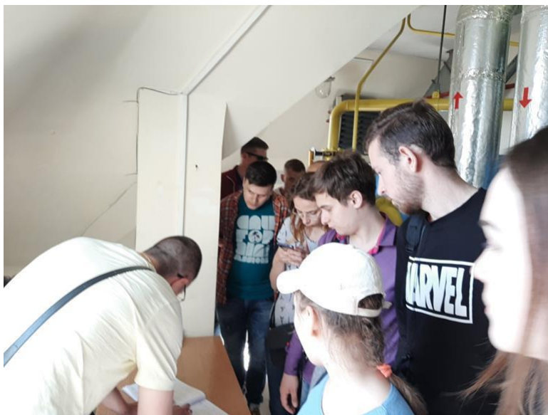
Дахова котельня ЖК Чудо-місто
