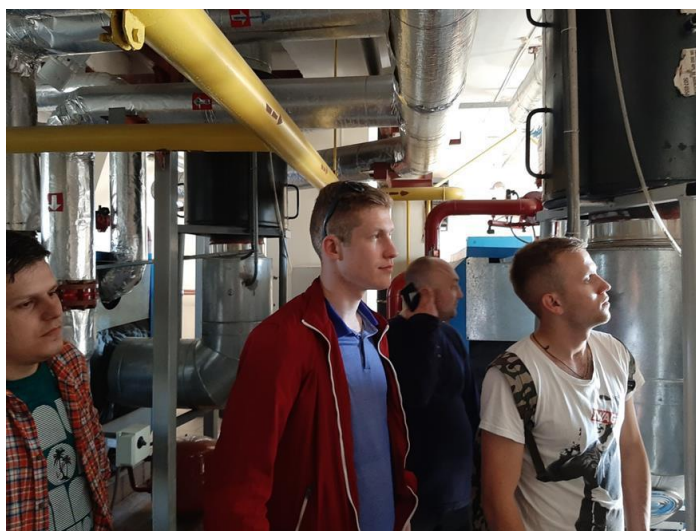
Центр хімічної водопідготовки котельної РК Чудо-місто
