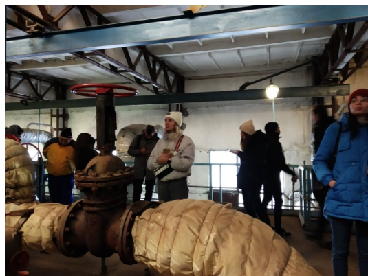
Котловий простір та засувки котла
